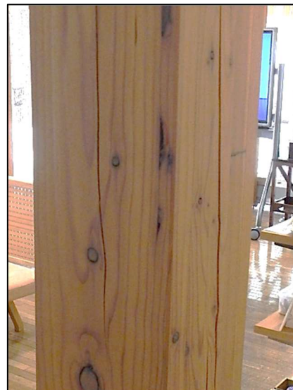
写真1 乾燥による割れが生じた集成材の例
