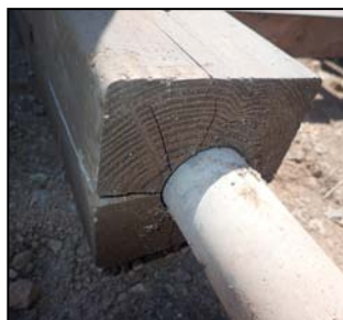
【写真21 スギ柱脚部】
